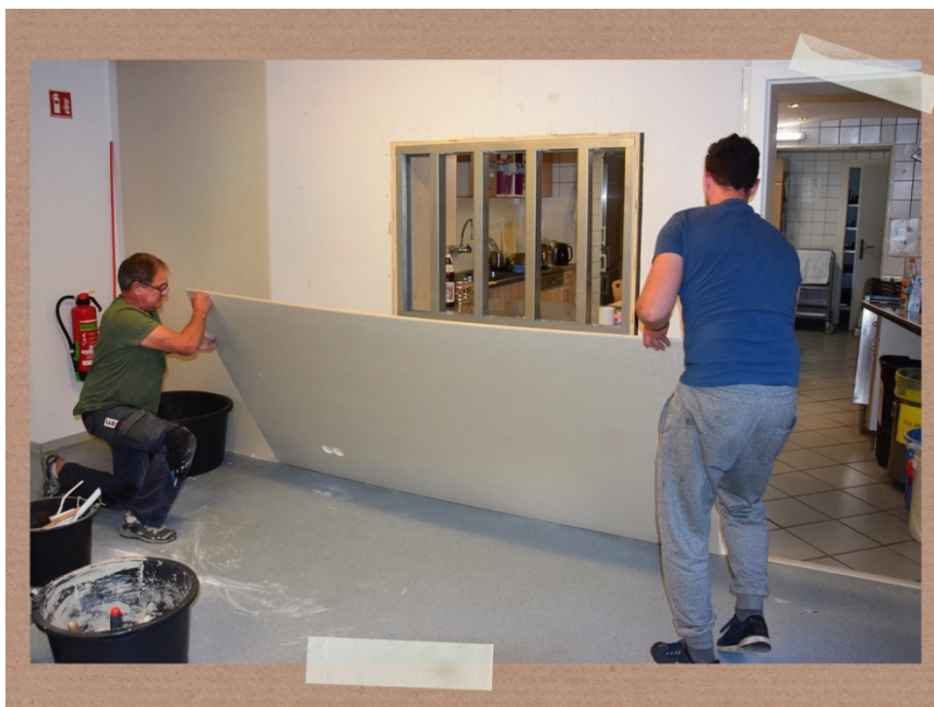
Verschluss der Durchreiche zur Küche
